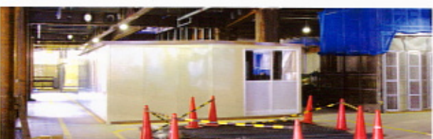
建設現場3階フロアーに設置
